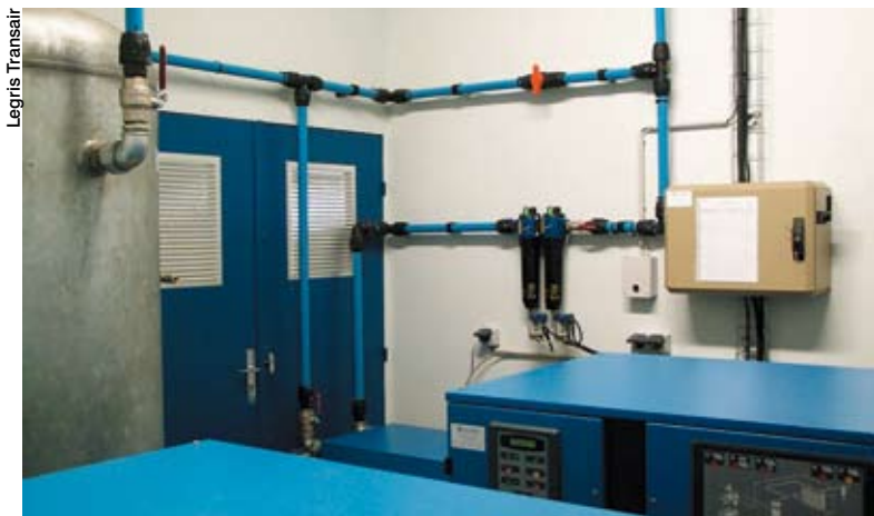
Le système de distribution d'air comprimé Transair de Legris permet de lutter contre la principale source de gaspillage : les fuites
